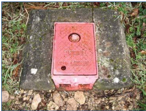
Bouche de lavage fermée
