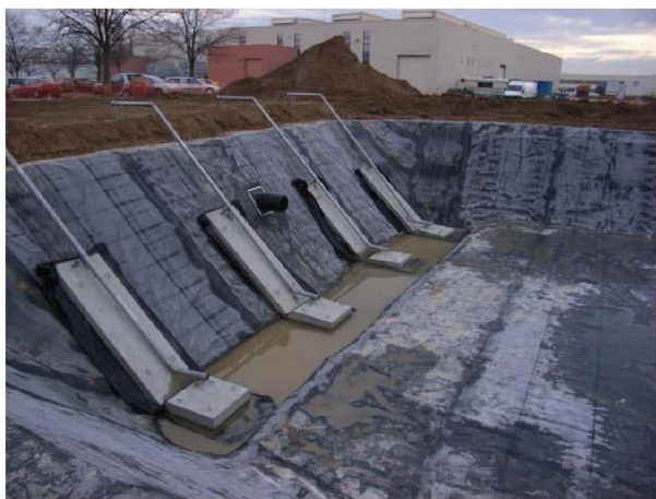
Réserve incendie 1500 m 3
