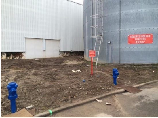
Réservoir aérien de 400 m 3 avec poteaux d'aspiration
